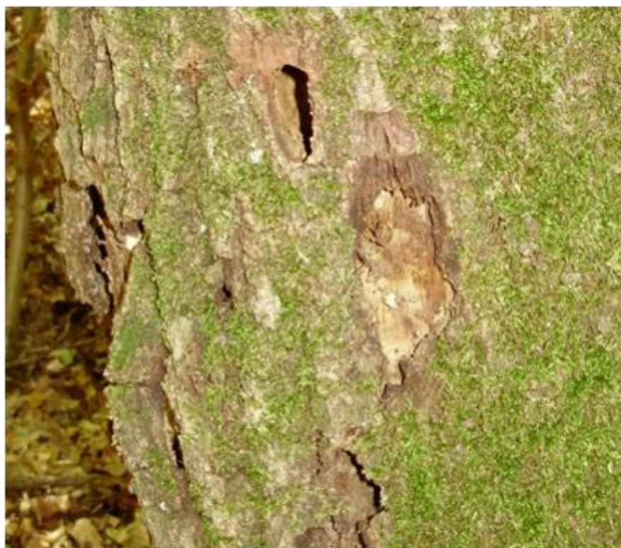
Слика 25.2. Оштећења од храстове стрижибубе Cerambyx cerdo Picture 25.2. Damage caused by the great capricorn beetle Cerambyx cerdo
